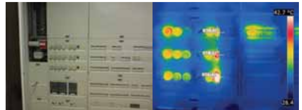
Dieses Wärmebild zeigt, dass die Arbeitsbelastung während des Betriebs nicht gleichmäßig auf die Sicherungskästen verteilt ist.
