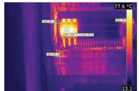
Die Sicherungen, die auf dem Wärmebild besonders deutlich hervortreten, sind überlastet und müssen ausgetauscht werden.
