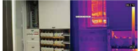
Obwohl diese Ausgangsklemmen wirklich heiß sind, liegen die gemessenen Temperaturen im Normbereich für diese Art der Belastung.
