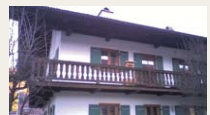
Fehlerhafte Isolierung über Balkonfenster
