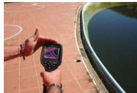
Die FLIR E60 Wärmebildkamera konnte die undichten Stellen eindeutig lokalisieren.
