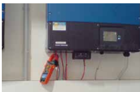
Diese Wechselrichter wandeln den Gleichstrom der Solarmodule in Wechselstrom um.
