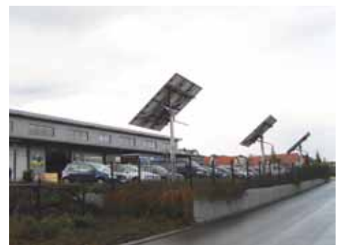
Diese auf Masten montierten Solarmodule lassen sich von hinten untersuchen, um Reflexionen zu minimieren.
